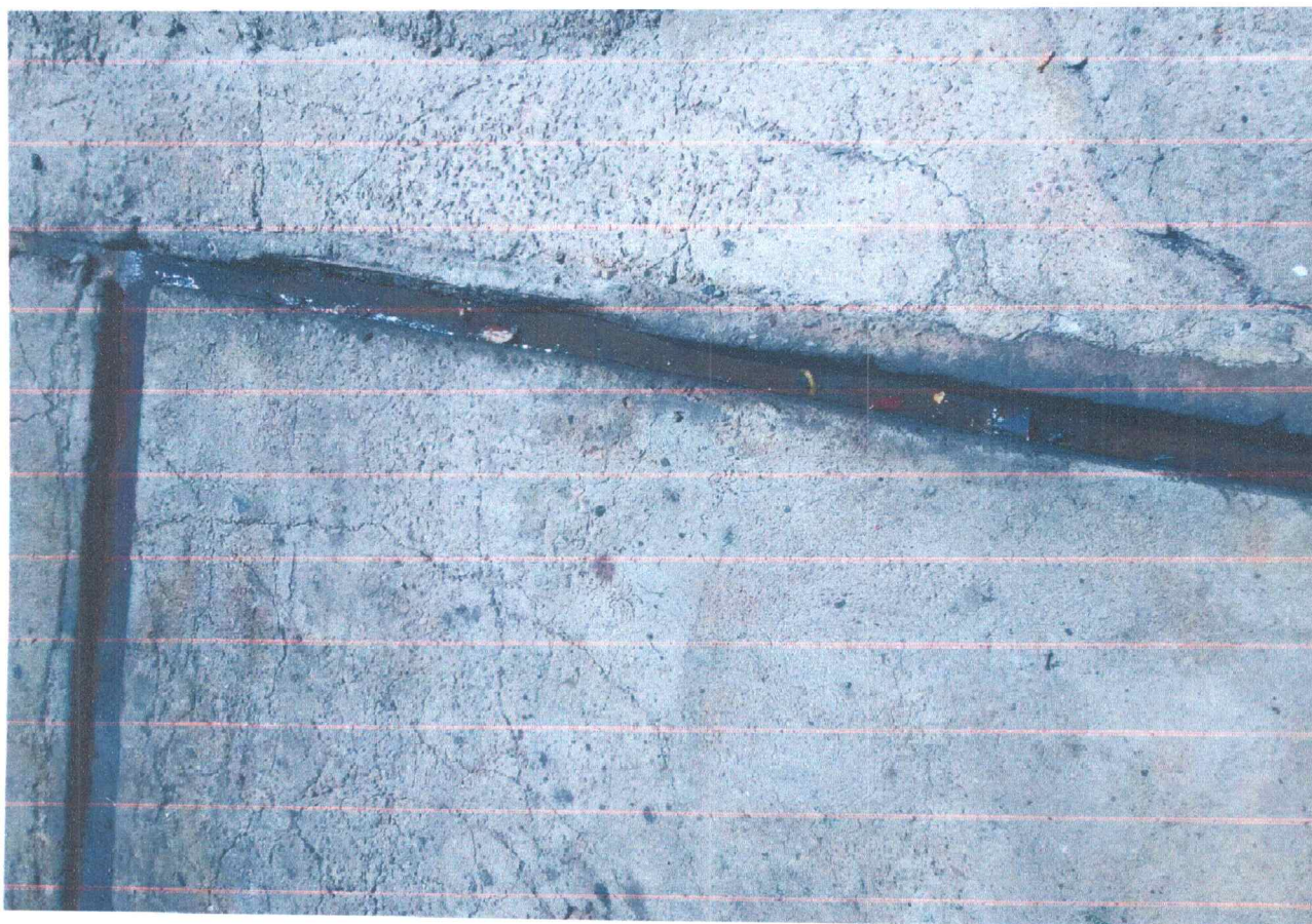
Foto 03: Foto das canaletas em mau estado de conservação, será notificado o proprietário para realizar as devidas manutenções – Fonte Semai 2020.
