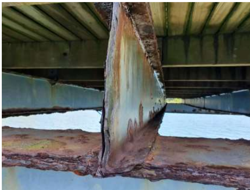
Figura 6 - Corrosão da estrutura de sustentação do píer.
