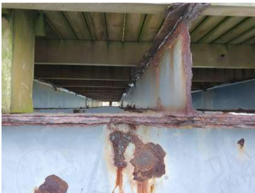
Figura 5 - Condições da estrutura de sustentação do píer.
